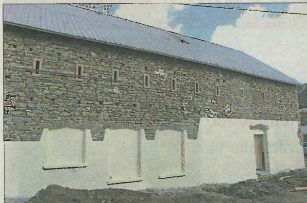
Auch die Sanierungsarbeiten an der alten Scheune neigen sich dem Ende zu.
